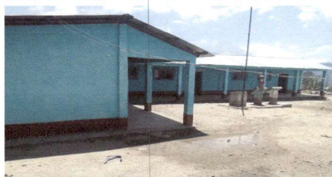
Foto 4: Pintura en muro exteriores
